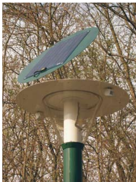
Fig. 3: Le lampade solari, combinate con sensori di movimento, sono interessanti per illuminare percorsi pedonali. Nella foto un progetto pilota a Zumikon.
